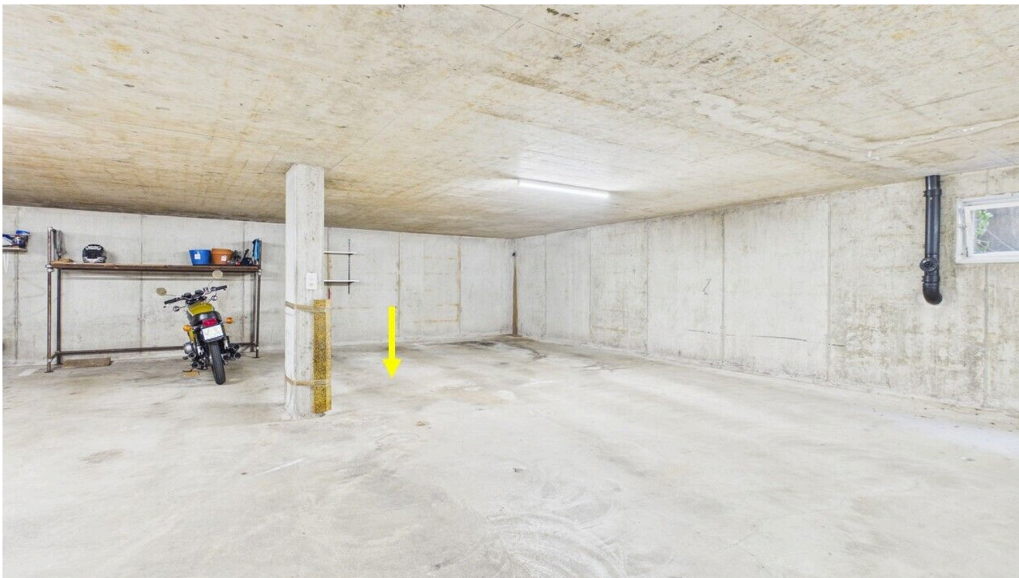
Parkplatz in der Einstellhalle
