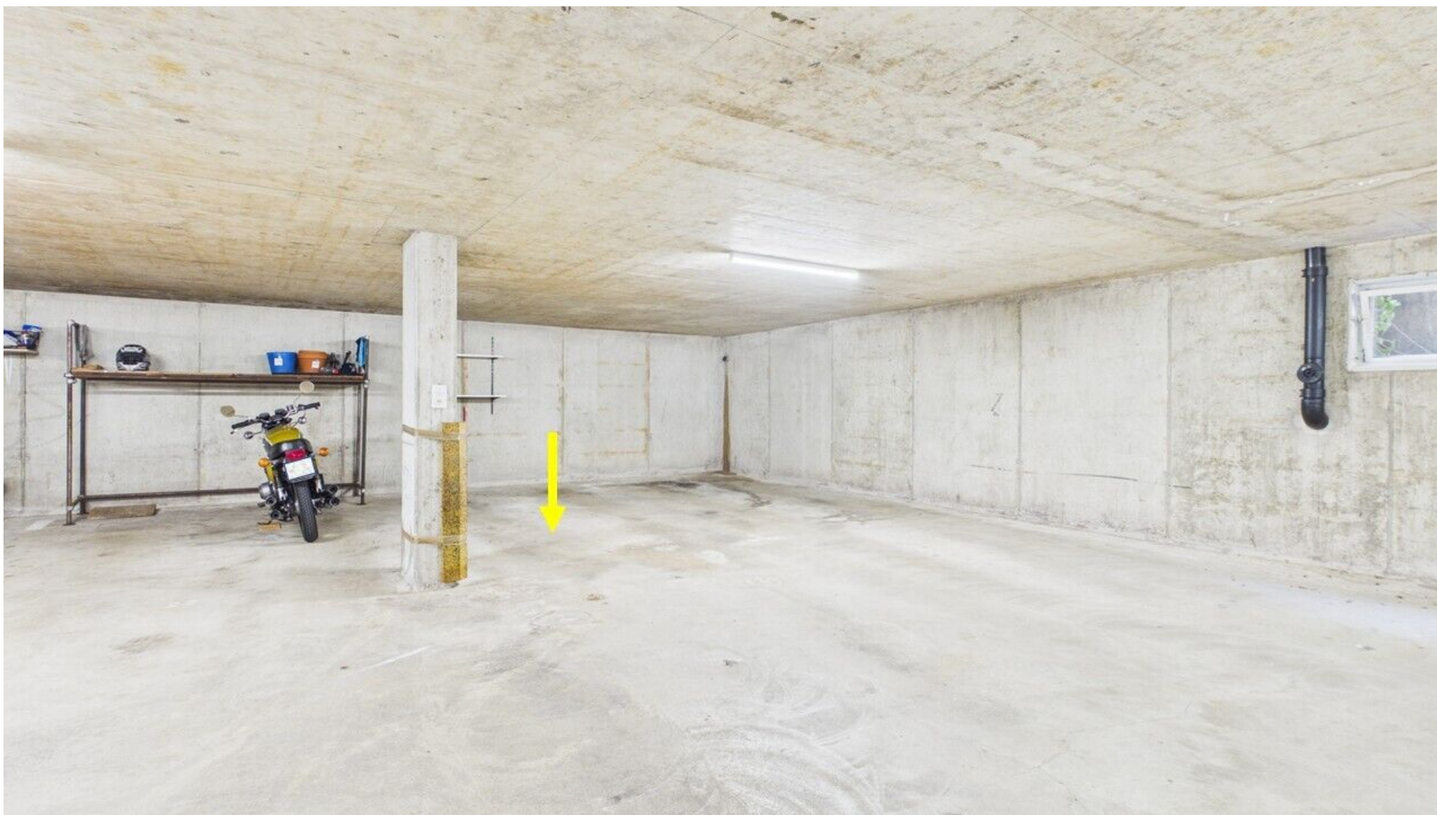
Parkplatz in der Einstellhalle
